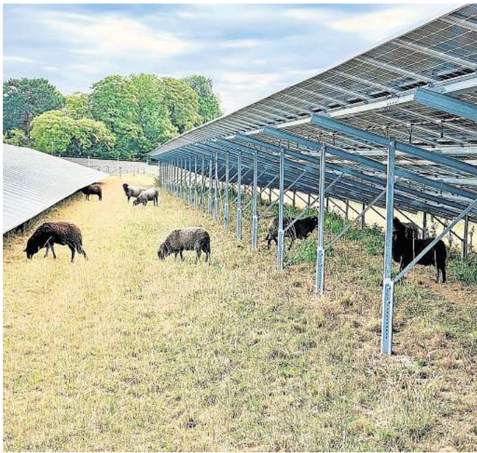
Die Teilnehmer der Fahrrad-Tour besuchen unter anderem eine Freiflächen-PV-Anlage, die auch tierisch benutzt wird.
