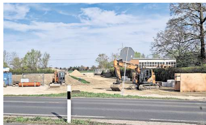
Verlauf ist zu erkennen: Die Bagger haben auf dem Acker hinter der Straßenmeisterei bereits eine Fläche frei gelegt.
