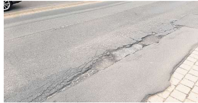
Auch innerorts problematisch: Die L391 weist tiefe Risse auf - hier auf Höhe des Penny-Markts.
