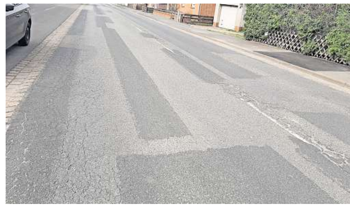
Muster auf der Straße: Die verschiedenen Grautöne auf der L391 lassen den Abschnitt wie einen Flickenteppich daherkommen.
