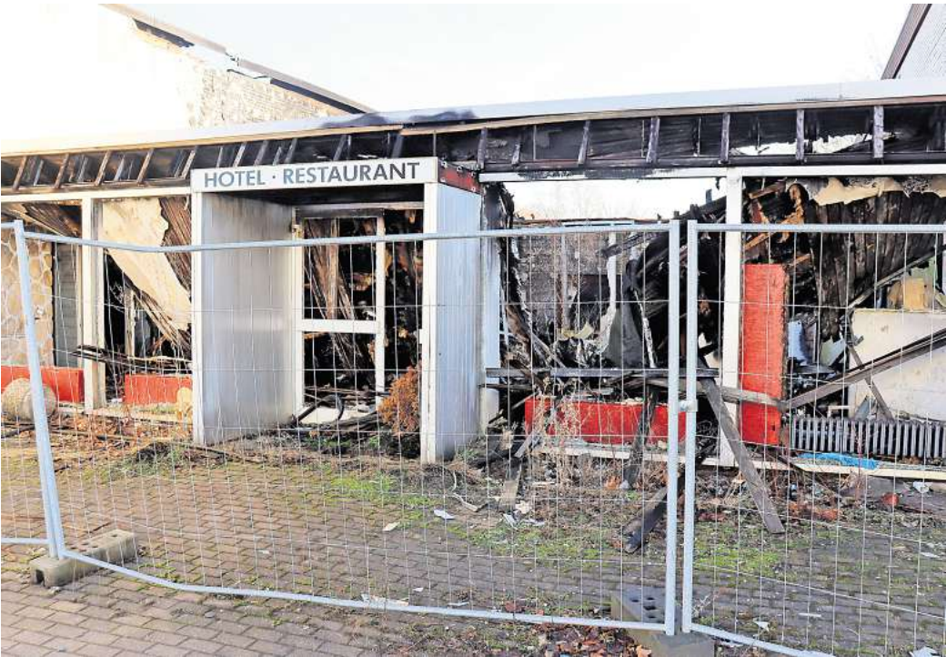
Brandruine als Hindernis für einen Sportheim-Ersatzbau: Der verwüstete Eingang des Sportparkrestaurants erinnert un- verändert an den Großbrand, bei dem auch das Vereinsheim von TuS und Borussia Empelde zerstört wurde.
