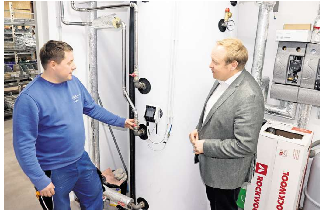
Gespräch über Pelletheizungen, Wärmepumpen und Gasheizungen: Firmenchef Philipp Lattmann (links) unterhält sich mit Tilman Kuban über die Auswirkungen des neuen Gebäudemodernisierungsgesetzes für Fachbetriebe.
