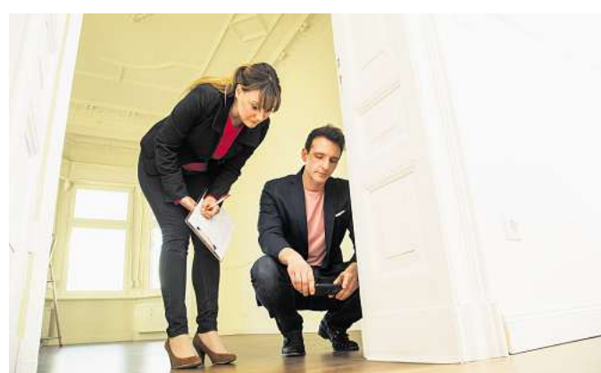
Möglicher Pilzbefall: Vor dem Kauf sollte ein Altbau von einem unabhängigen Sachverständigen kontrolliert werden.
