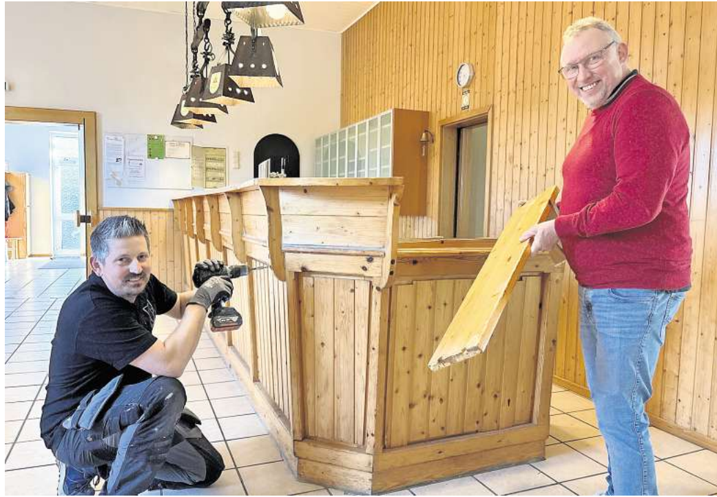
Tresen wird komplett erneuert: Lars Reichardt (links) und Holger Urbanek vom Vorstand der Dorfgemeinschaft Evestorf haben mit der Demontage des Tresens im DGH begonnen.
