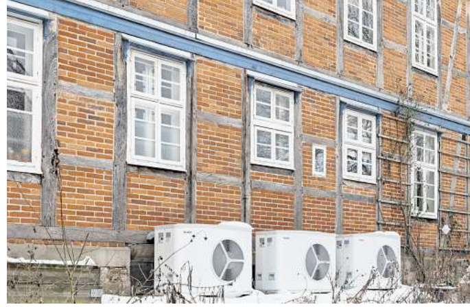
Die Luft-Wasser-Wärmepumpenkaskade beheizt das historische Gebäude effizient und klimafreundlich. FOTO: JOACHIM LÜHRS
