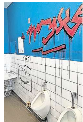
Beschmierte Schultoilette: Der entstandene Schaden durch Vandalismus im Schulzentrum Am Spalterhals geht in die Zehntausende. FOTO: STADT BARSINGHAUSEN
