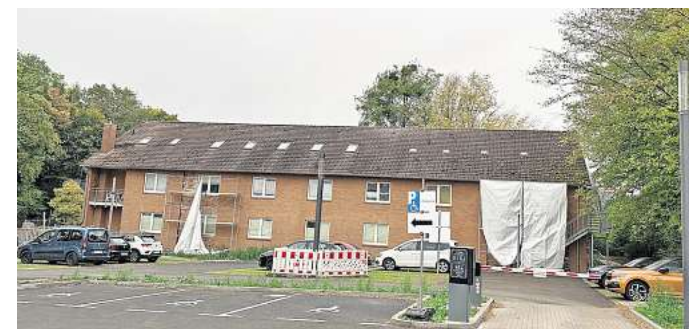
Erblich beschädigt: Das Verwaltungsgebäude des Klinikums Robert Koch in Gehrden weist Risse in der Fassade auf. Es kann nicht genutzt werden. FOTO: DIRK WIRAUSKY
