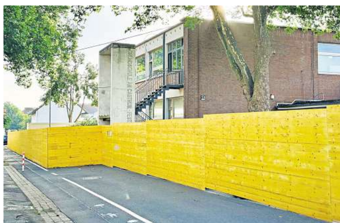
Gelber Bauzaun als Schutz: Die Tage der alten Grundschule Am Castrum sind gezählt. Das Gebäude wird zurzeit Stück für Stück abgerissen.
