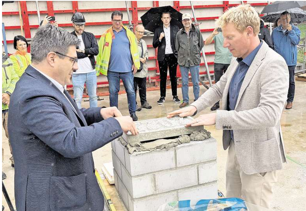
Der Grundstein für die Mensa ist gelegt: Zum symbolischen Start der Hochbauarbeiten mauerten Bürgermeister Ingo Kloke (l.) und KGS-Schulleiter Kai Birkner eine Zeitkapsel ein.
