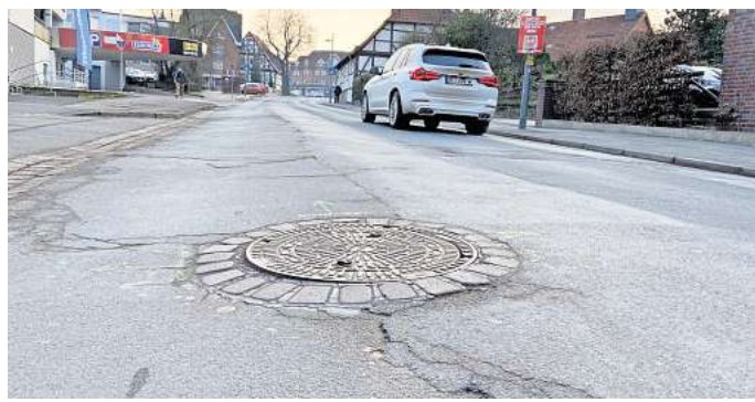
Nur eine der rissigen Straßen: Im ersten Bauabschnitt der Innenstadt-Sanierung wird ein Teil der Rehrbrinkstraße erneuert. FOTO: JENNIFER KREBS
