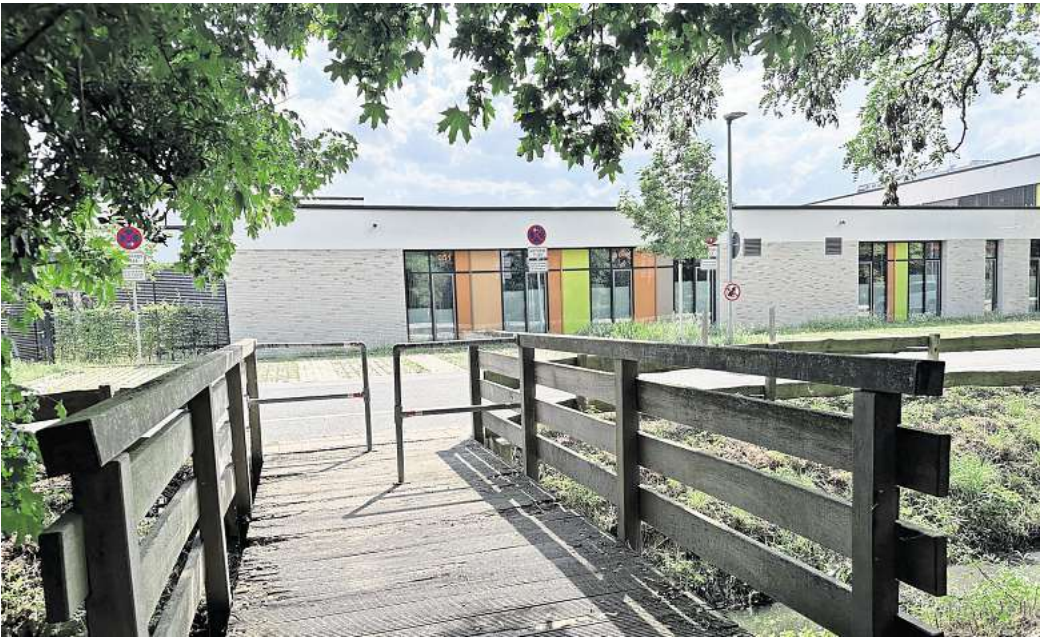
Schäden sichtbar: Eine der drei Holzbrücken Auf dem Hagen befindet sich direkt gegenüber der neuen Grundschule (hinten)
