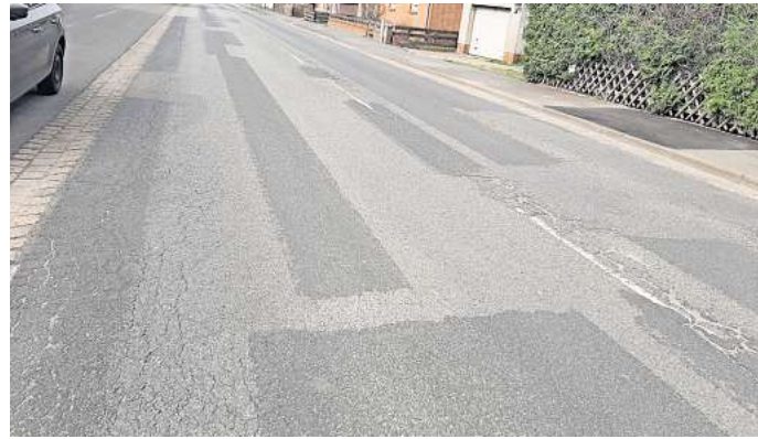
Muster auf der Straße: Die verschiedenen Grautöne auf der L391 lassen den Abschnitt wie einen Flickenteppich daherkommen.
