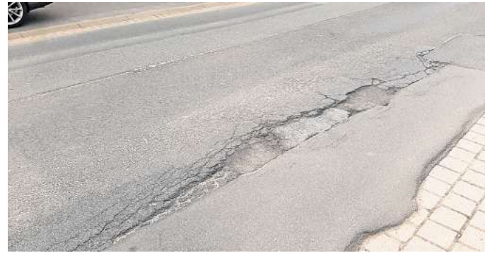
Auch innerorts problematisch: Die L391 weist tiefe Risse auf - hier auf Höhe des Penny-Markts.
