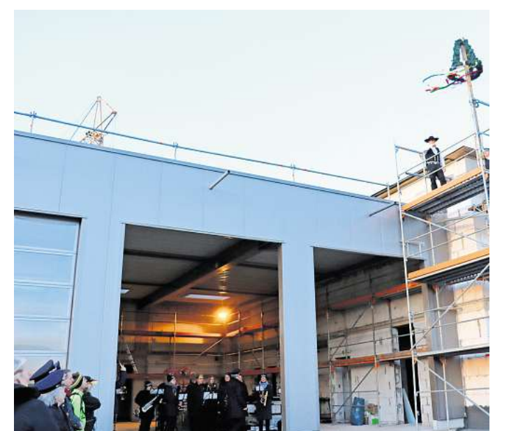
Das nächste Etappenziel ist erreicht: Für das neue Feuerwehrhaus in Degersen wird rund drei Monate nach der Grundsteinlegung bereits das Richtfest gefeiert.
