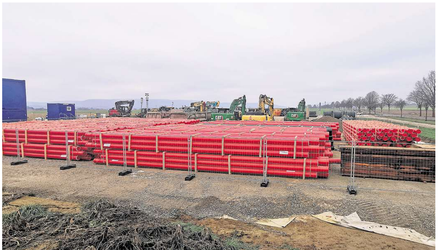
Die Südlink-Baustelle zwischen Gestorf und Völkens: Zurzeit sind dort keine Arbeiter zu sehen. Denn noch ist der Boden nach dem Frost zu weich.
