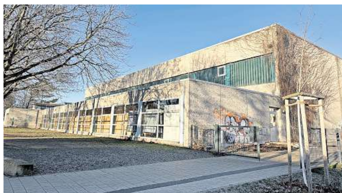
Sanierung oder Abriss? Für die alte Sporthalle an der Langen Feldstraße soll ein Gutachten eingeholt werden.
