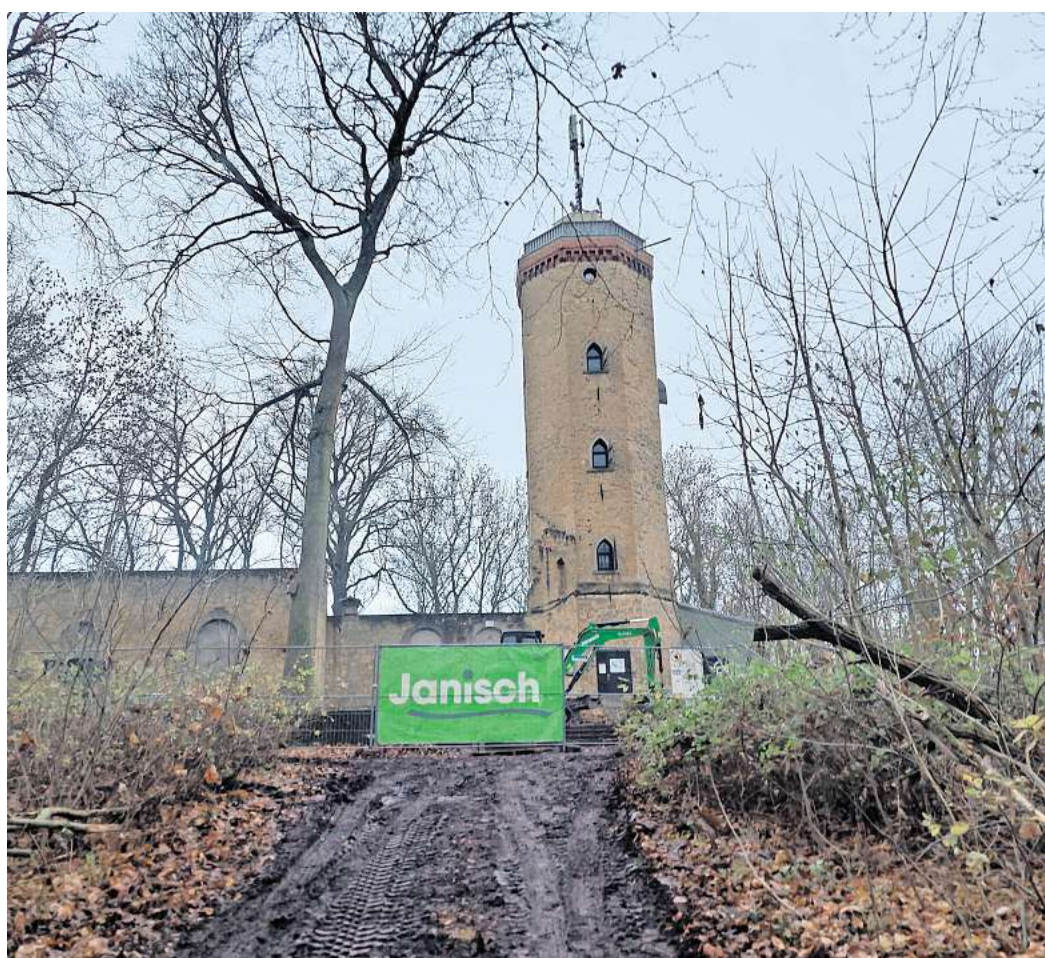
Eigentlich ein idyllisches Plätzchen: Vor dem Burgbergturm am Gehrden Berg ist momentan eine Baustelle.
