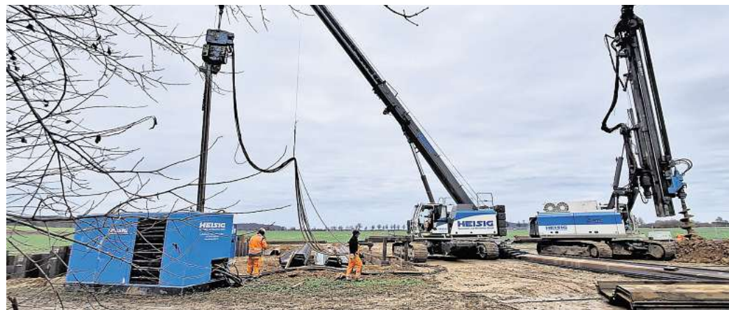
Großes Gerät: Zwischen Weetzen und Lemmie treiben die Tiefbauer Spundwände in den Boden. Für das Südlink-Kabel werden hier Mini-Tunnel unter der Bahnlinie hindurch gebaut.
