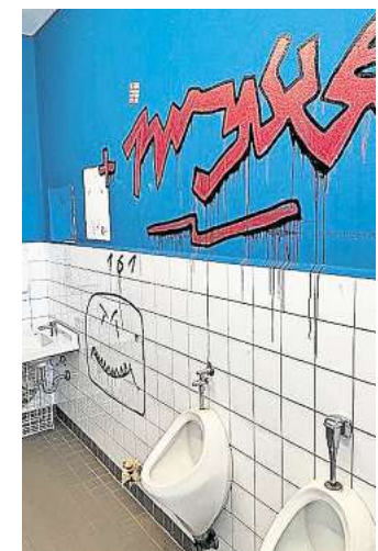
Beschmierte Schultoilette: Der entstandene Schaden durch Vandalismus im Schulzentrum Am Spalterhals geht in die Zehntausende. FOTO: STADT BARSINGHAUSEN
