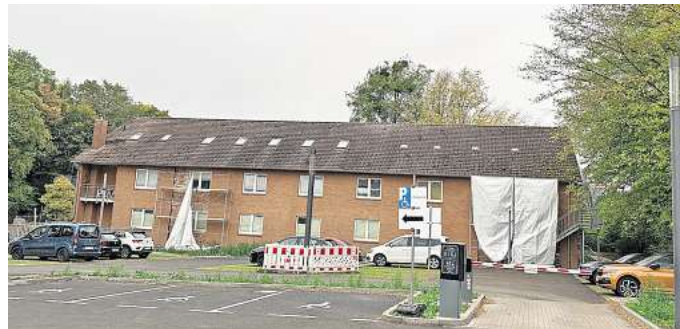
Erheblich beschädigt: Das Verwaltungsgebäude des Klinikums Robert Koch in Gehrden weist Risse in der Fassade auf. Es kann nicht genutzt werden. FOTO: DIRK WIRAUSKY
