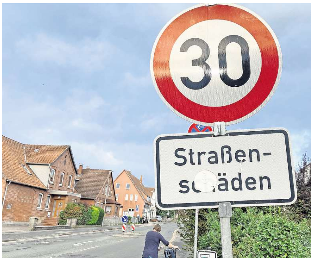
Tempolimit wegen der Straßenschäden: Auf Teilen der L391 – wie hier auf der Stoppstraße kurz vorm Kirchdorfer Bahnübergang – gilt Tempo 30 statt Tempo 50.
