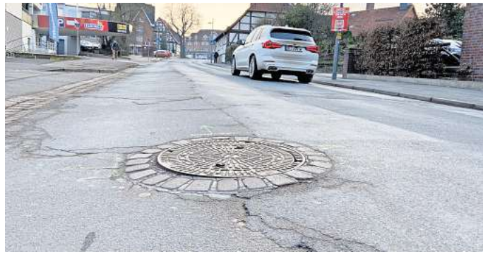
Nur eine der rissigen Straßen: Im ersten Bauabschnitt der Innenstadt-Sanierung wird ein Teil der Rehrbrinkstraße erneuert. FOTO: JENNIFER KREBS
